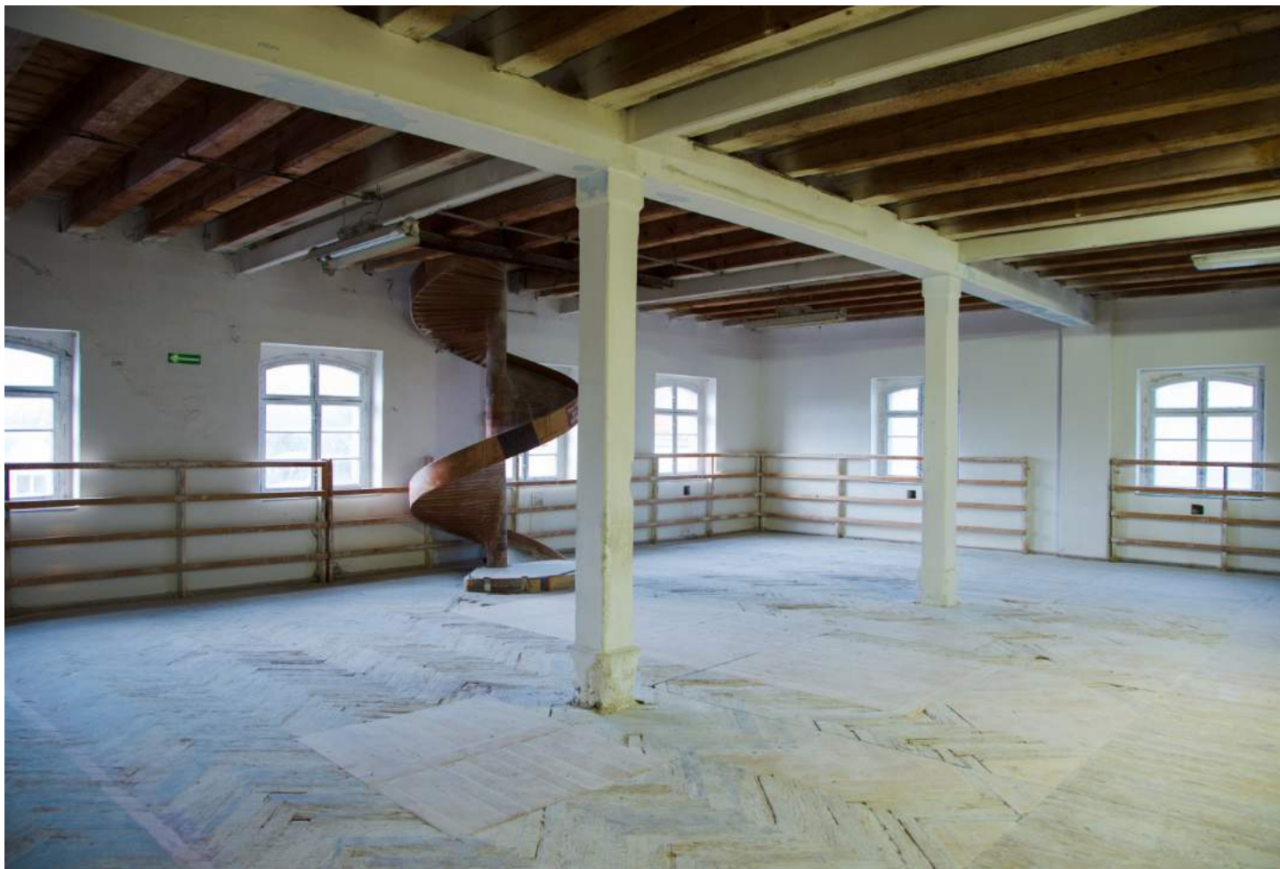
Magazyn mąki z ześlizgiem do transportu worków
