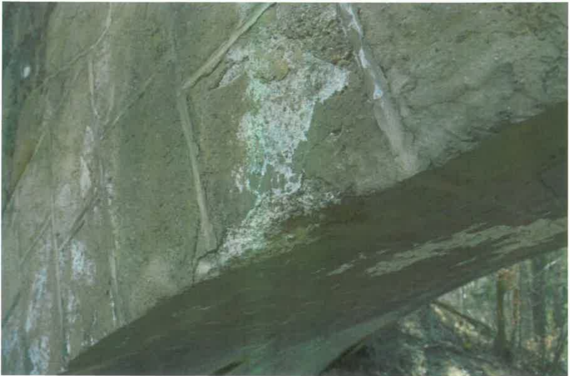
Most nad Jeziorem Pilchowickim. Sklepiony przyczółek południowy, czoło wschodnie, jeden z blozków betonowych użytych do odbudowy przęsła, widoczne kruszywo o grubej frakcji. Fot. K. Czartoryski, 16.03.2020.
